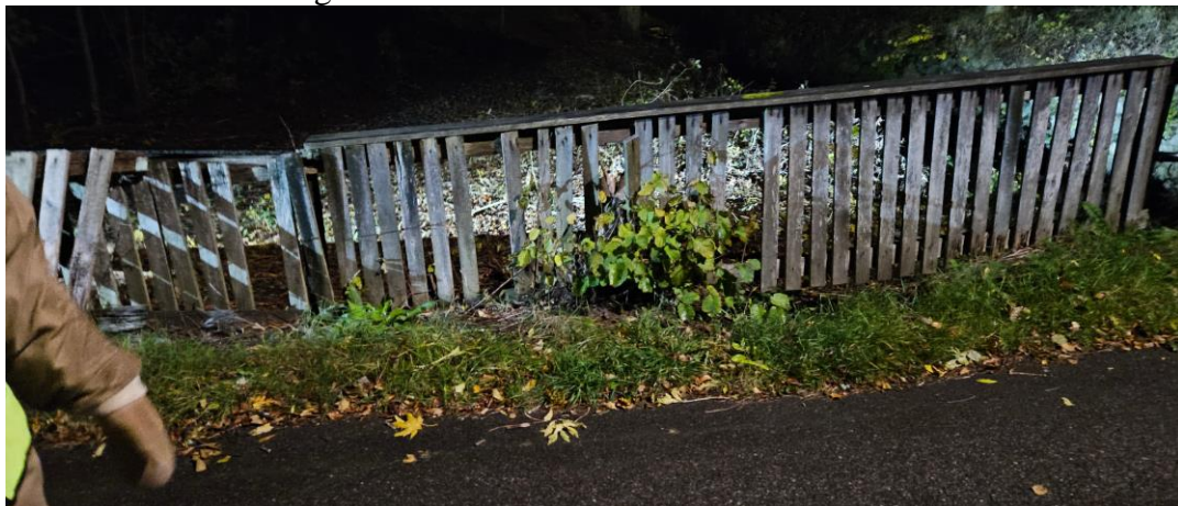
Bild ff, trasigt staket.
