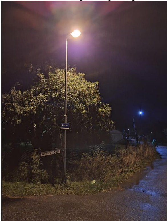
Bild U: Sporadiskt fungerande belysning, Villavägen/Parkvägen.
