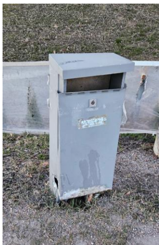
Foto E, Skadat elskåp.
