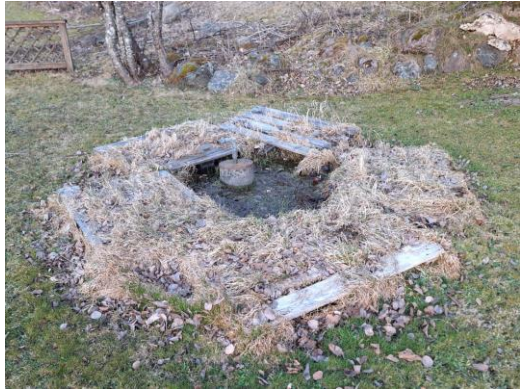
Foto P, Brunn med risk för oönskade flöden.
