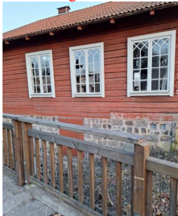
Foto Z, Trasiga fönster på byggnad.
