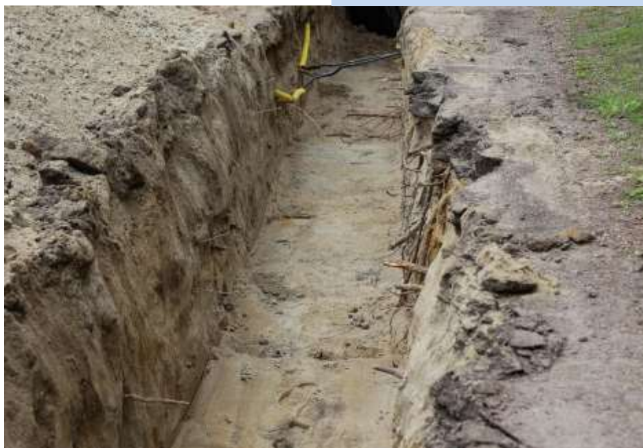
Korrekt beskurna rötter i kabelgrav.
