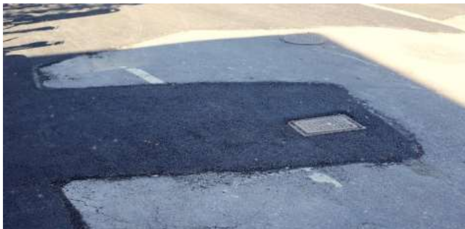
Felaktig återställning; asfaltsöar har ej avlägsnats, asfaltskanterna ej sågade korrekt, skarvar ej förseglade, plattad ej återsatt. Återställningen saknar en rektangulär eller kvadratisk form.
